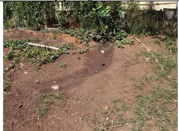
Verificação de escoamento irregular de esgoto doméstico.
