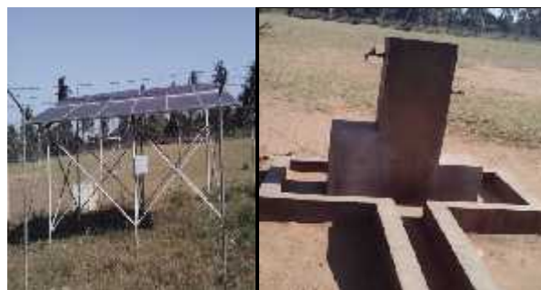
Figura 3: Furo para abastecimento local de água (avariado)
