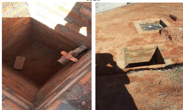
Figura 6: Detalhe do acabamento do reator anaeróbico de fluxo ascendente e da caixa de lodo
