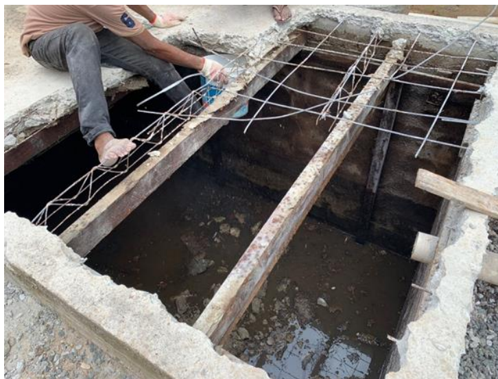
Figura 8 - Paredes da fossa séptica sem impermeabilização
