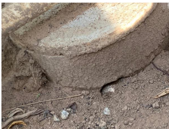
Figura 11 - Caixa de passagem não selada
