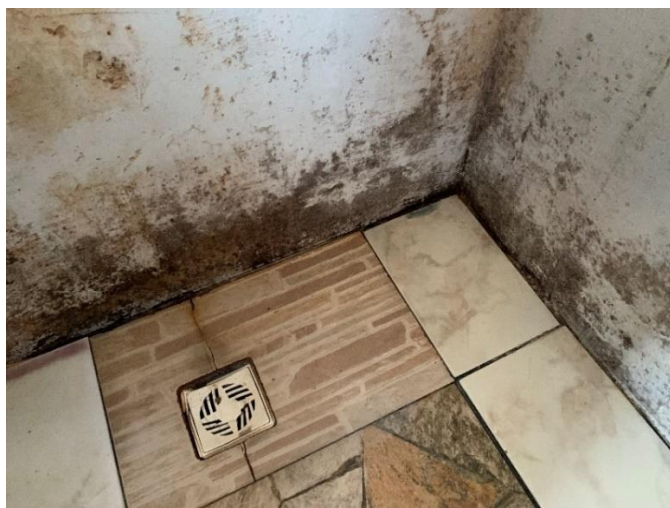
Figura 9 - Piso com infiltração e mancha na parede.
