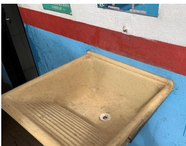
Figura 6 - Lavatório sem torneira
