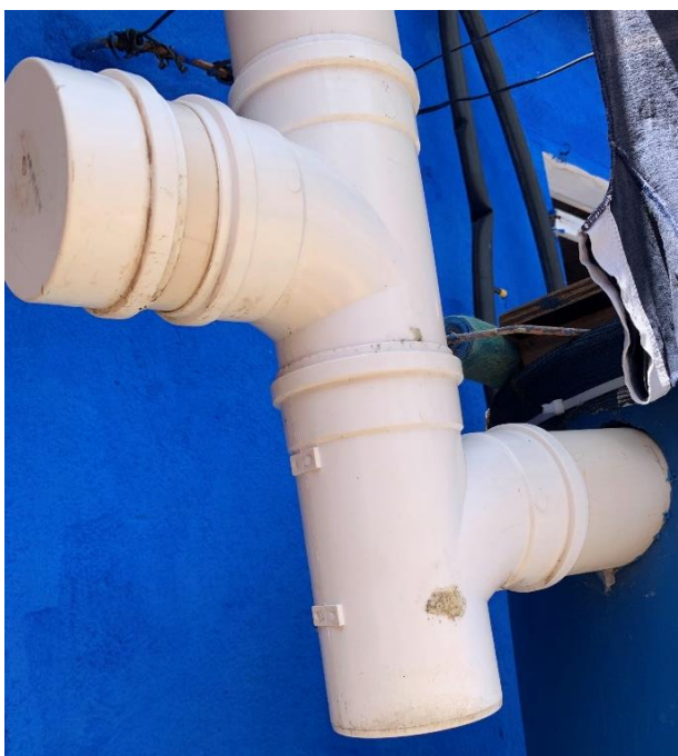
Figura 10 - Tubo de ligação à cisterna, retirado o fundo pela própria comunidade
