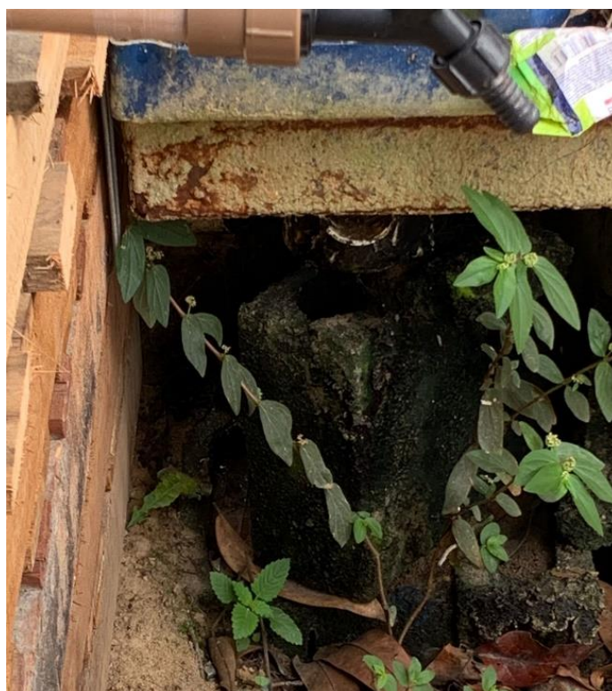
Figura 7 - Vazamento na arte inferior do módulo
