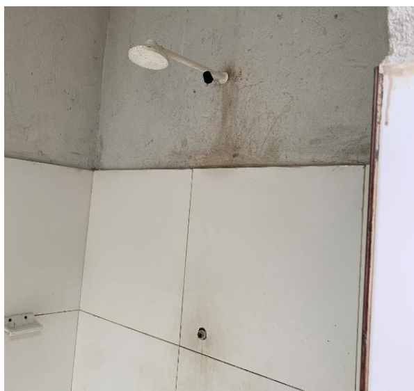
Figura 5 - Chuveiro sem registro
